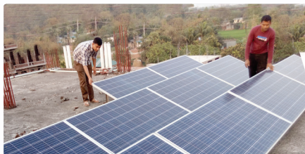
Солнечные панели обеспечивают работу фонарей и камер наблюдения
